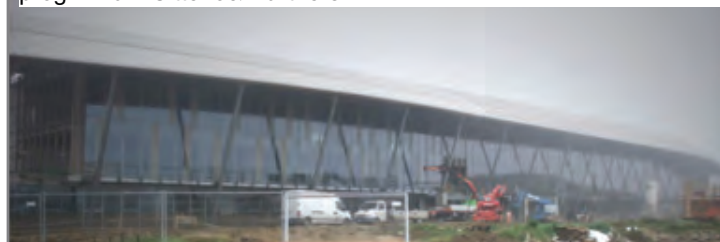
nuovi uffici Tecnogym Cesena 11.000 m2 imp. Tecnimont To prog. Arch. Citterio& Partners MI
